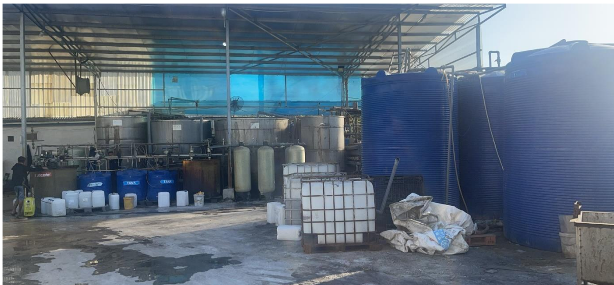
Hình 6. Hệ thống xử lý nước thải
