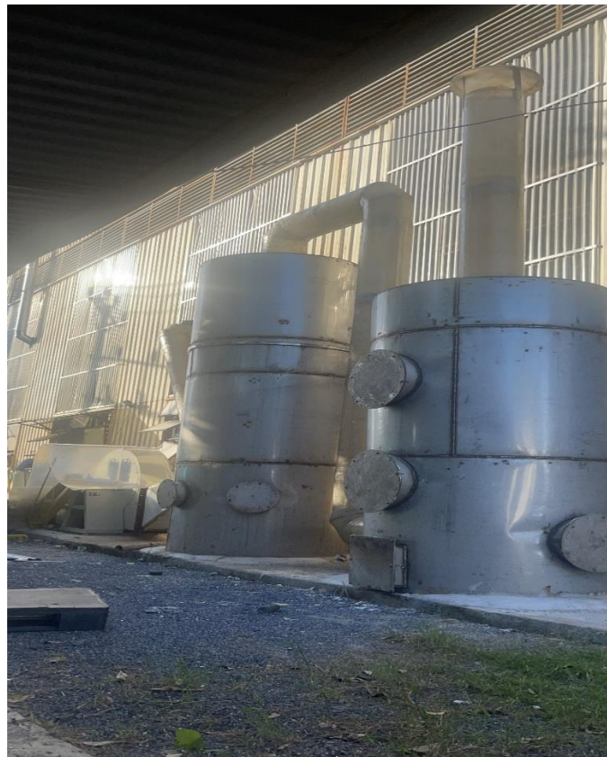
Hình 8. Hệ thống xử lý khí thải
