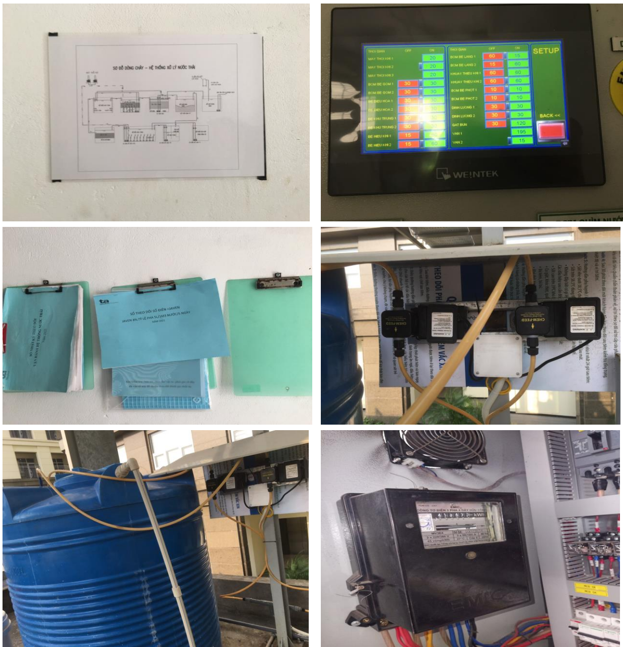
Công tơ điện hệ thống xử lý nước thải
